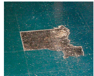
2 Einschichtige asbesthaltige Bodenbeläge, Asbest im Kunststoff festgebunden (Floor-Flex)
