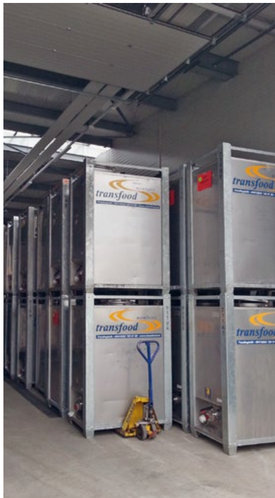
Beheizbarer Trocknungsraum für Lebensmittelcontainer.
